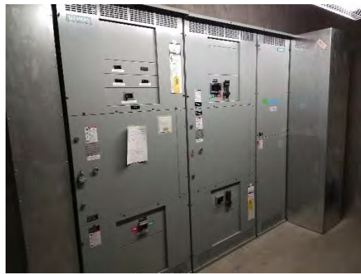
Item 54 - Main Switchgear
